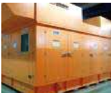
コージェネレーションシステム エネルギーを有効活用するため、ガスから電気と熱を同時に発生。排熱を有効利用し、省エネに貢献。370kW×2台（計740kW）
