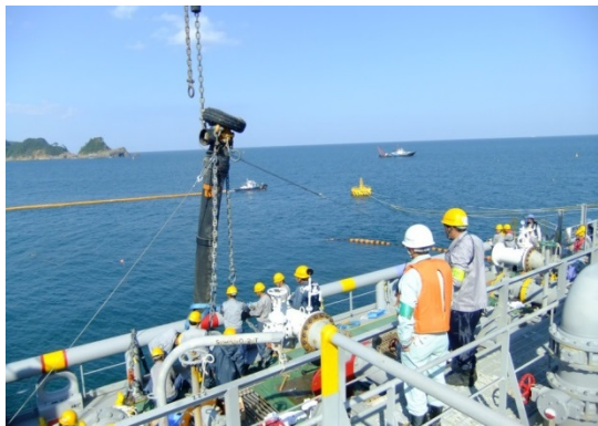
マリンホースの接続
