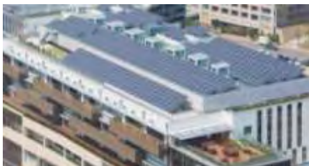
ショップ&オフィス棟屋上の太陽光発電
