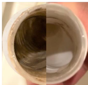
洗浄前/洗浄後
