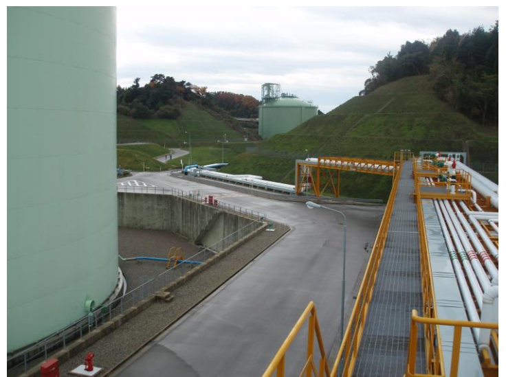
七尾基地から隣接基地への移送配管
