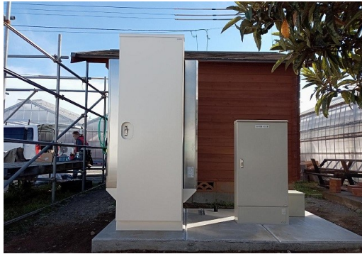
写真3：屋外ラック・分電盤
