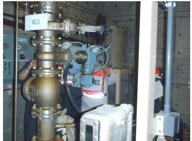
ポンプ手動作業
