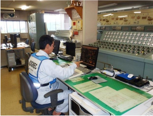
制御盤にエラーメッセージ表示(中央操作室)
