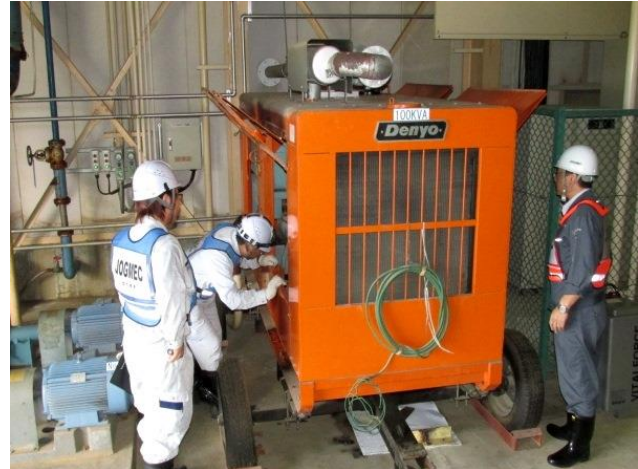
手動操作に必要な電源の非常用発電機起動準備
