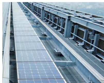
屋上に設置された太陽光パネル
