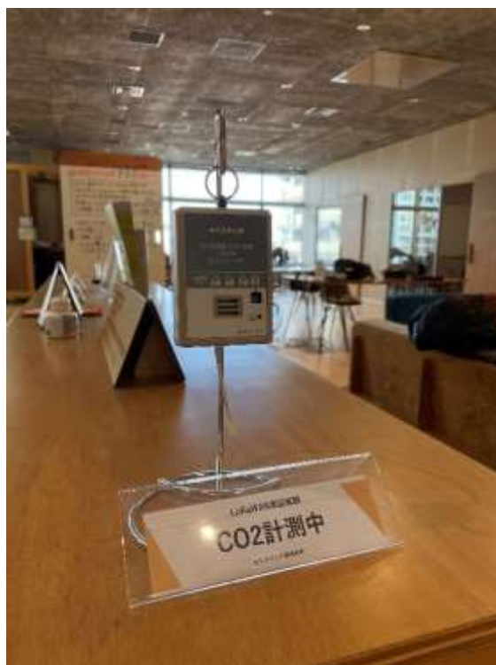
執務空間内に設置した温度・湿度・二酸化炭素の計測センサー
