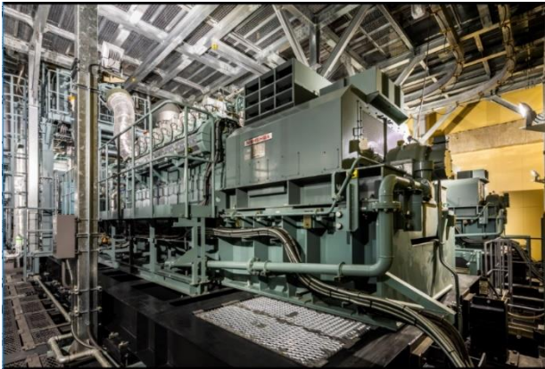
豊洲エネルギーセンター 8階 コジェネレーションシステム(CGS)
