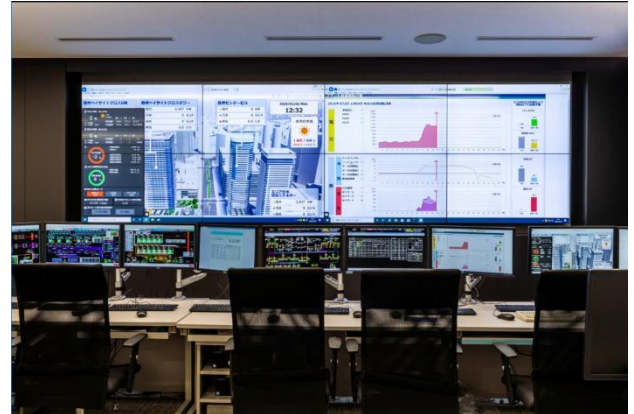
豊洲エネルギーセンター 5階 中央監視室
