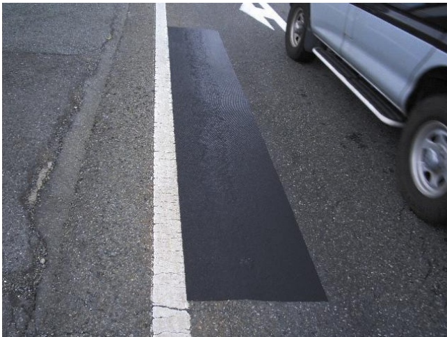
3M™ ステイマーク™ 路面補修材 L715 をクラック補修部に施工した路面
