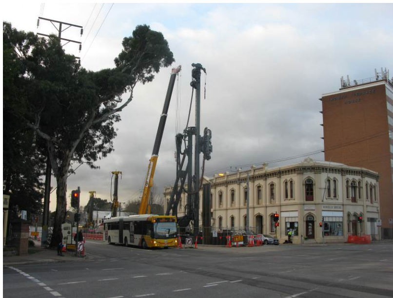
写真 2. オーストラリアの市街地におけるハット形鋼矢板の打設状況 (1)
