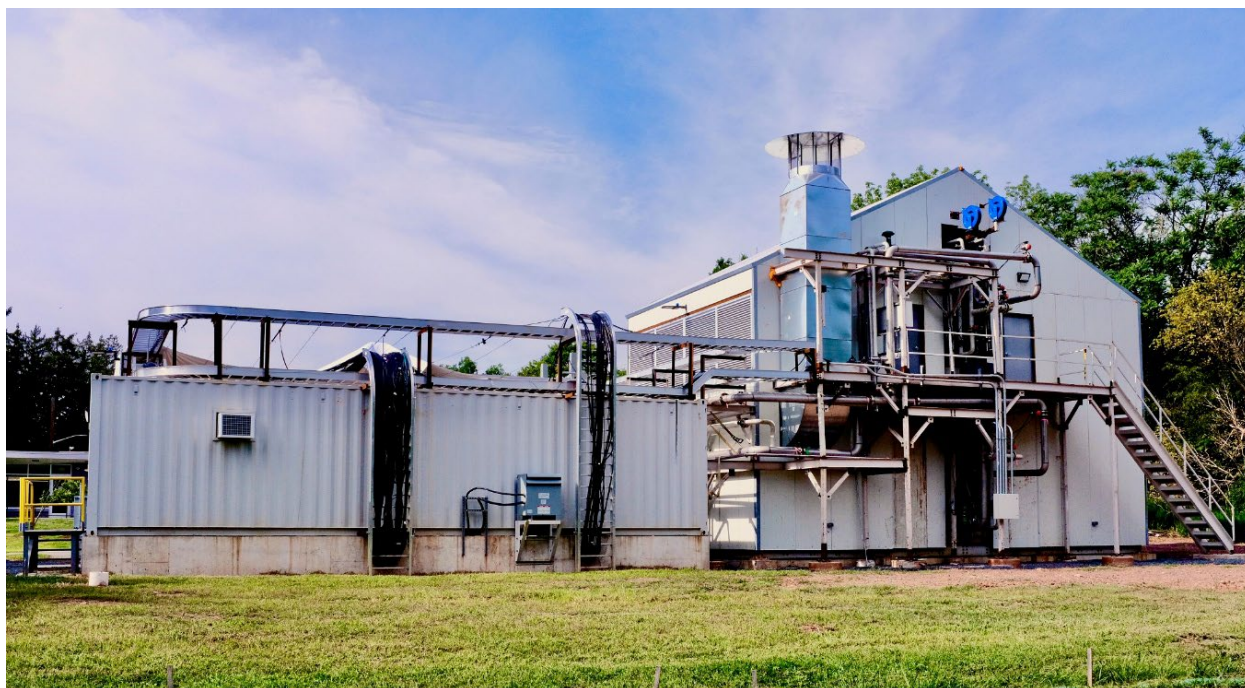
「Project Brighton」の DAC 設備
