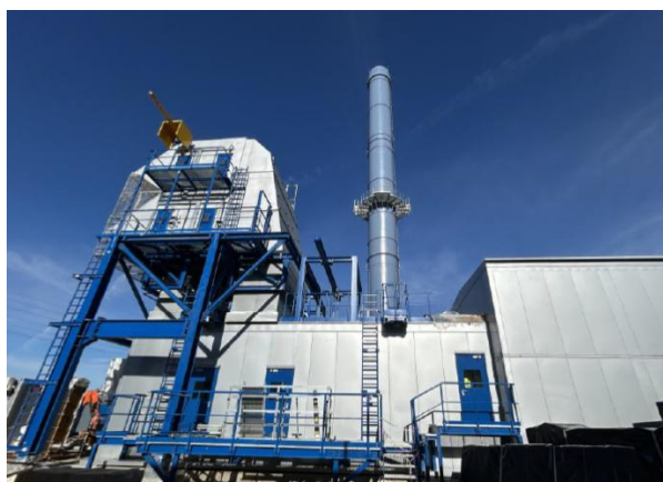
設置工事が完了した発電設備
