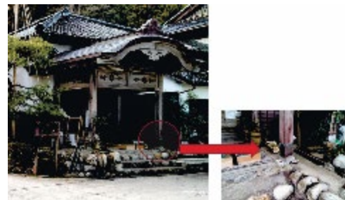
被災後の和倉御便殿本殿と損傷した式台柱
