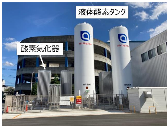
液体で保管している燃焼用の酸素を気化させて 窯へ供給します
